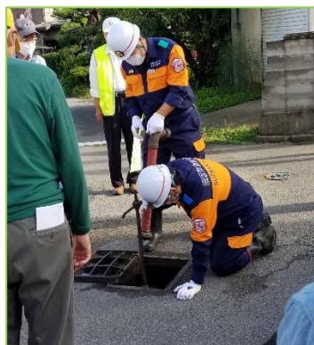
地下式消火栓
