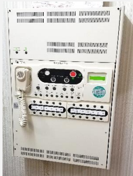
非常用館内放送設備
